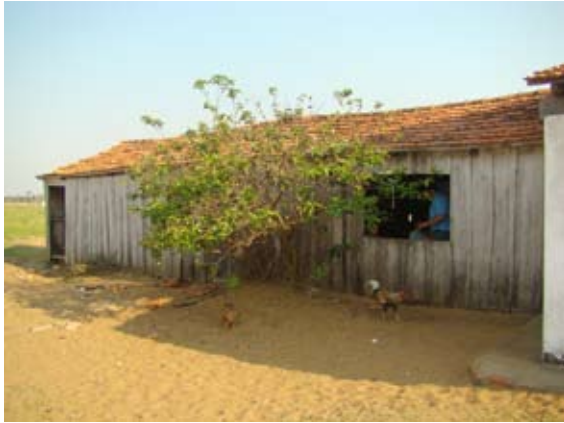
E. Básica 2352 "Alejandro Falcón" de Ayolas. Las débiles paredes de madera apenas pueden sostener el pesado techo de tejas.
