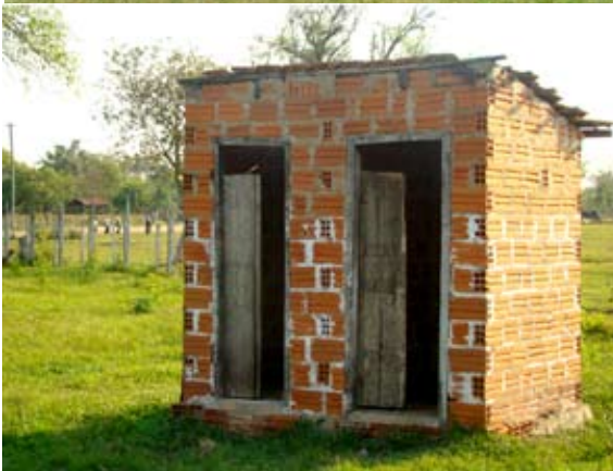
Imágenes que se repiten sobre las precarias condiciones de los baños de numerosas Instituciones Educativas.
